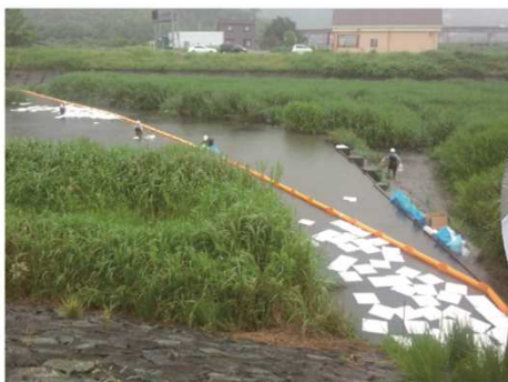
油等流出事故対策状況
