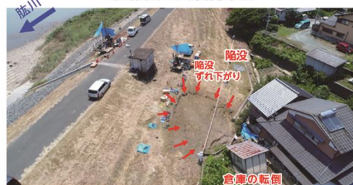
パイピング発生箇所 (H30.7月豪雨) 中島箇所の堤防漏水状況
