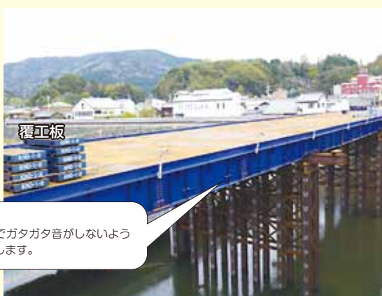
覆工板を設置します 橋桁の上に覆工板を設置して敷き詰めていきます 覆工板は人や車が通行する道路になる部分です
