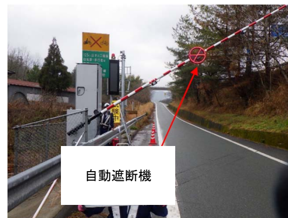
自動遮断機の設置
