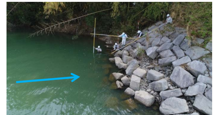
②低水護岸崩壊箇所
