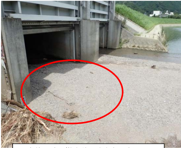
堆積土砂の撤去前 (大久保川樋門)
