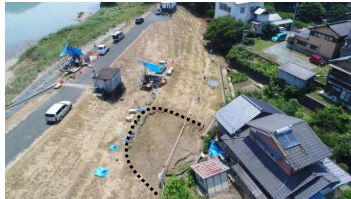
③堤防の法崩れ箇所
