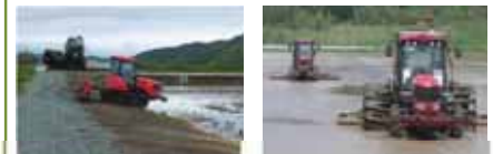
農機の旋回を容易にし、作業効率を向上させるターン農道の整備
