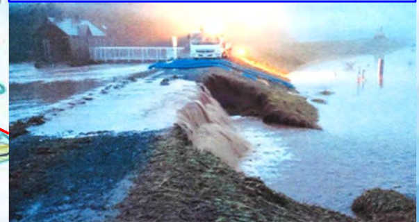
常呂川の堤防法崩れ(左岸18.6K) (北見市常呂自治区)
