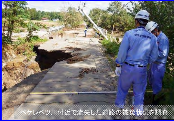
TEC-FORCEによる被災状況調査(清水町)
