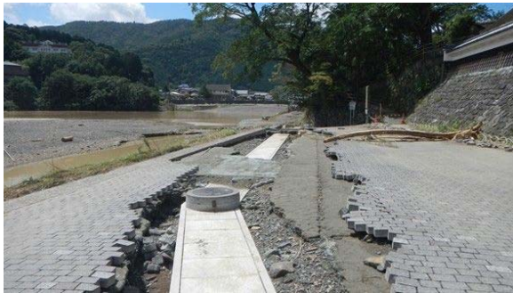
洪水による被災状況
