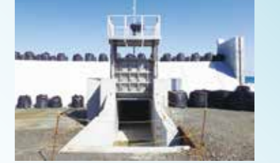
◀◀ 初崎堤防のゲート設備
