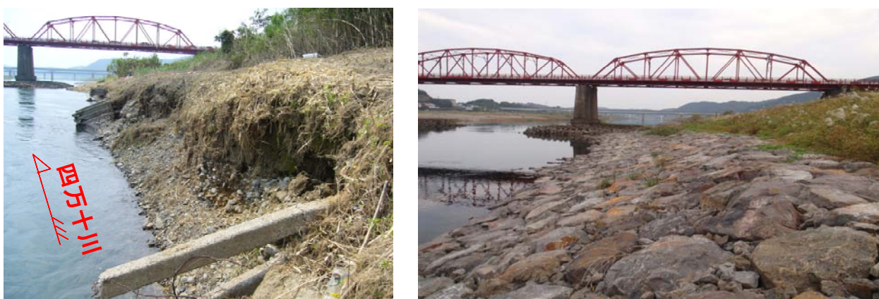
図4.2.5 平成19年7月洪水による具同箇所の護岸被災状況（左）と対策状況（右）
