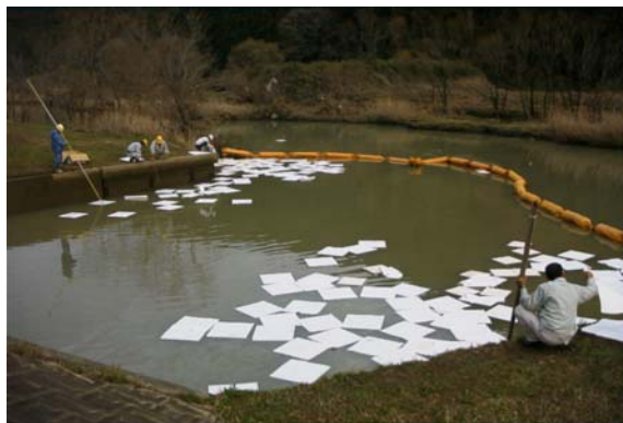
写真4.2.10 油の流出事故対策
