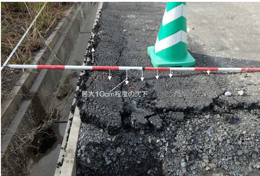
【路肩沈下の状況】
