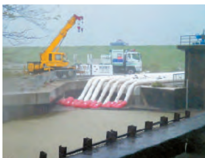
楠島地区排水状況
