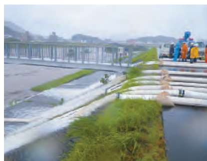
古津賀地区排水状況
