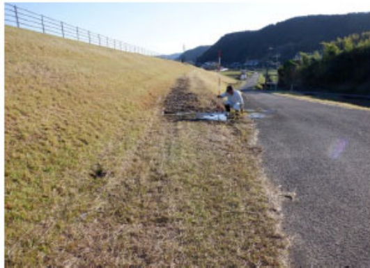
5.8km+160m付近 排水不良状況(R4.11.14調査時)
