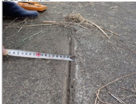
目地部 湧水(漏水)跡
