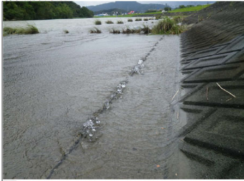
湧水(漏水)状況
