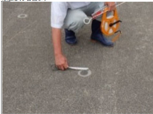
水抜き孔 目詰まり
