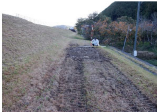
5.4km+150m付近 排水不良状況(R4.11.14調査時)
