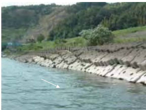
洪水による局所洗掘状況
