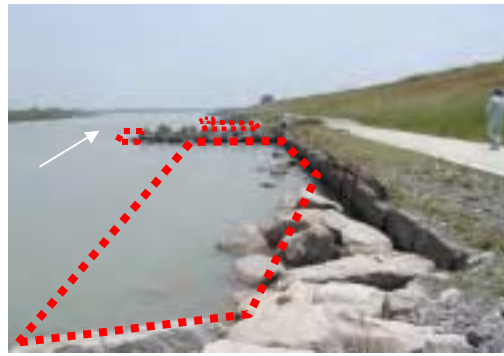
平成16年5月洪水による洗掘状況 (大京原地先：阿南市那賀川町)
