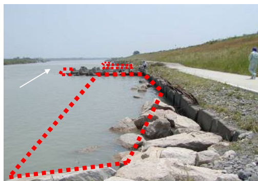
平成16年5月洪水による深掘れ（洗掘）状況 （大京原地先：阿南市那賀川町）
