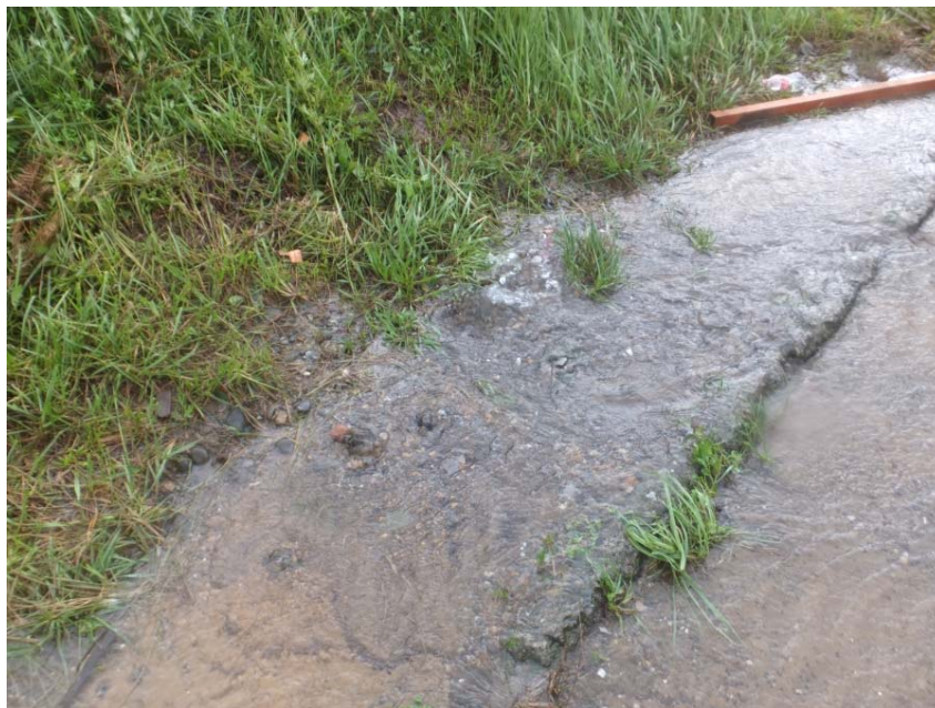
漏水状況(H26. 8. 10)
