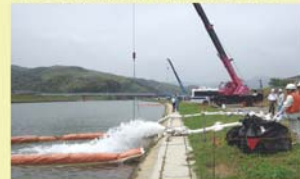
排水ポンプ車操作訓練状況
