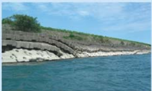
局所洗掘による被災
