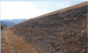
老朽化した護岸
