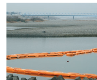
■シルトフェンスの設置状況
