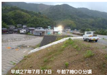
▲深瀬地区排水ポンプ稼働状況
