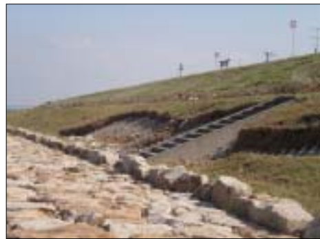
柳島箇所法面崩壊
