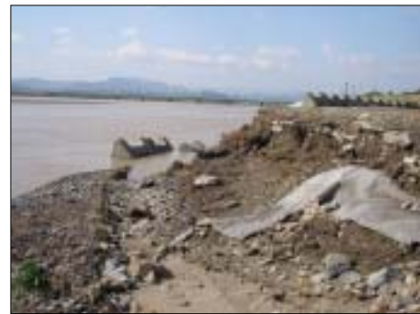
中島箇所低水護岸崩壊
