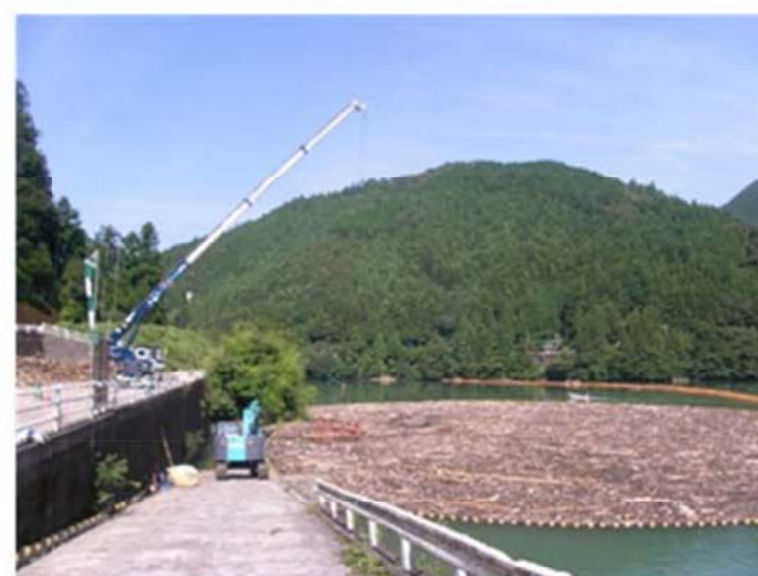
流木処理状況 (H24・前線による出水)
