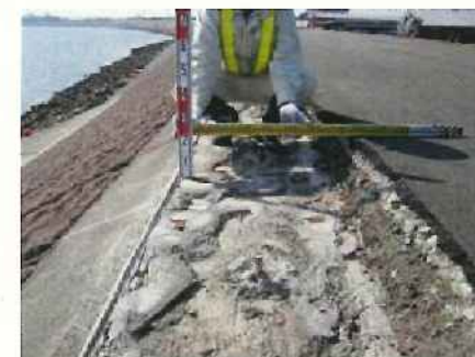
パラペット流失 (1.4k付近)
