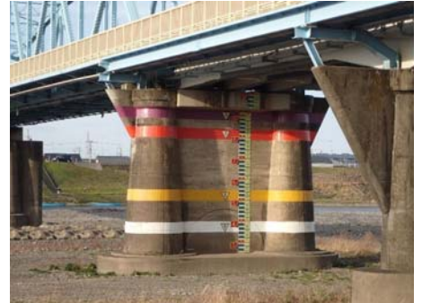
那賀川橋（古庄水位基準観測所）の量水標
