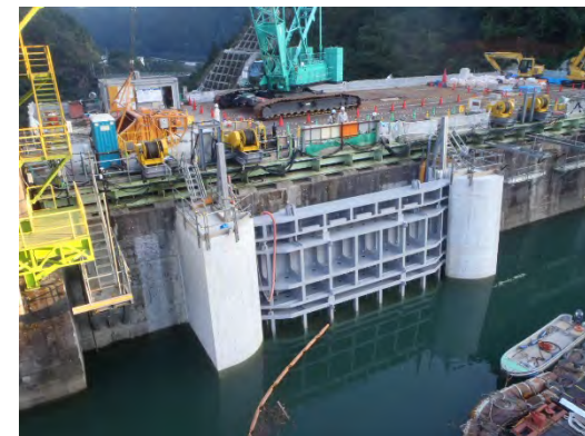
予備ゲート設置状況
