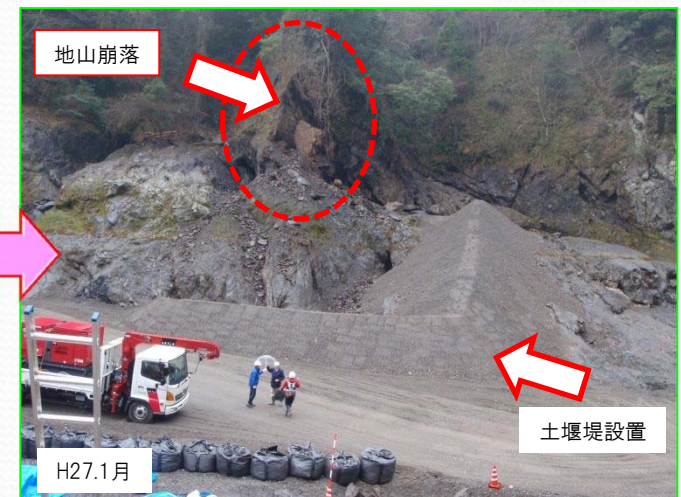
詳細調査実施のため、土堰堤にて立入禁止処置
