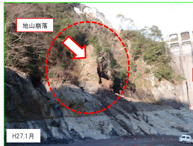
崩落確認後、区画明示にて立入禁止処置
