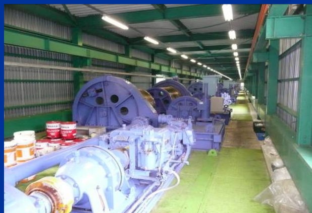
開閉装置全景
