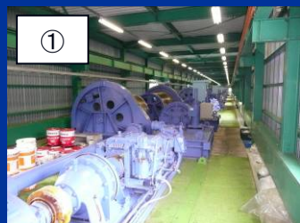
【開閉装置全景】
