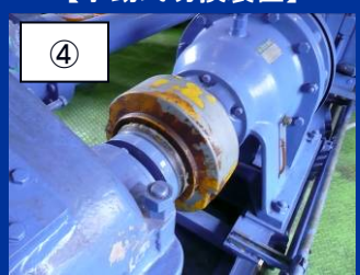
【カップリング部の塗装の劣化】
