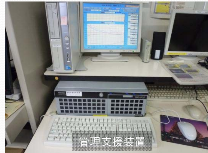
制御処理装置
