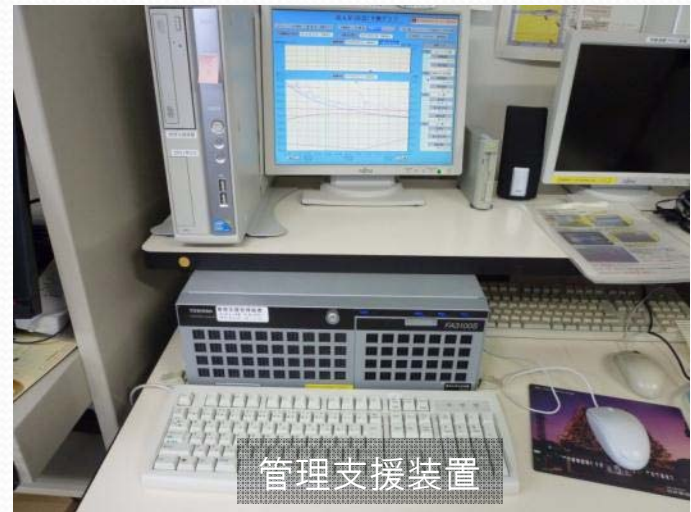
制御処理装置
