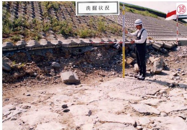
局所洗掘の被災状況（柳島箇所）
