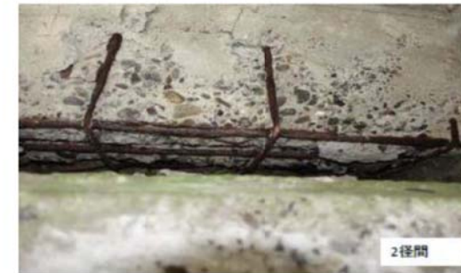
横桁損傷状況
