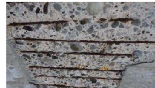
床版損傷状況
