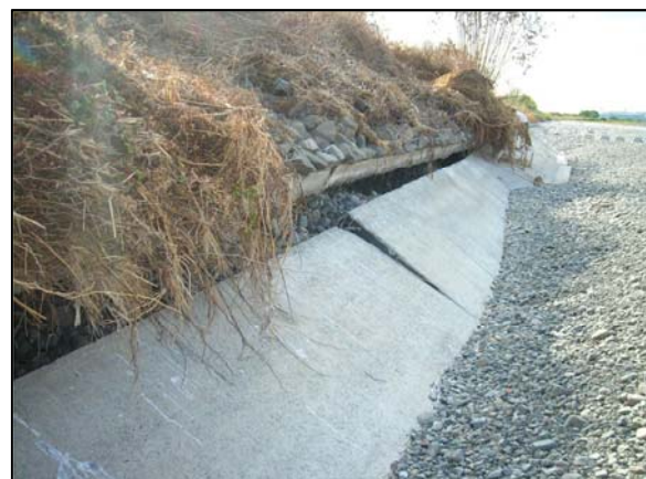
平成 22 年 7 月洪水(7.4k 左岸付近)
