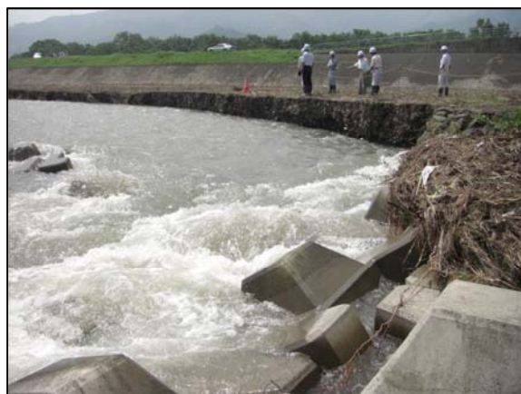
平成 21 年 7 月洪水(14.1k 左岸付近)
