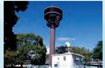
放流情報表示装置 ダム放流時、電光表示板に「雨のため増水に注意」と表示し危険を知らせます。
