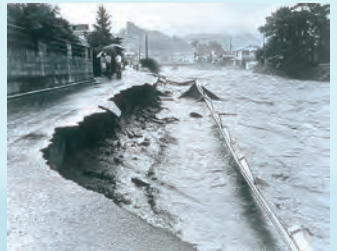
[S57] 石手川の被災状況 松山市溝辺町
