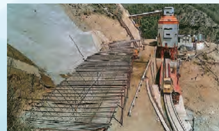
バッチャープラント 材料を混ぜ合わせダムコンクリートをつくる施設
