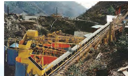
骨材設備 ダムコンクリートの骨材をつくる施設
