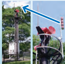
警報局 ダムから放流する前に、サイレンと音声及び回転灯で危険を知らせます。
