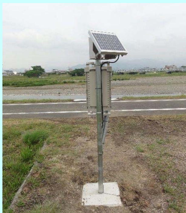
通信、電源装置等
