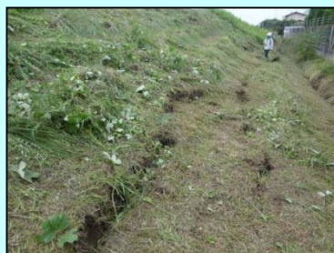
H29.9に重信川右岸2k/5付近で発生した漏水による法すべり
