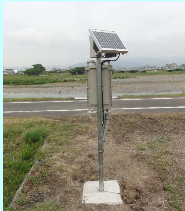
通信、電源装置等
