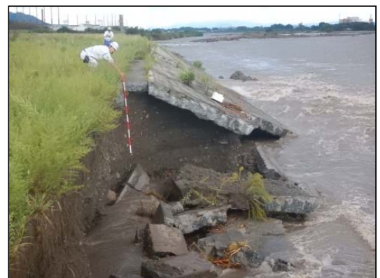
被災状況(東温市久谷地先)
