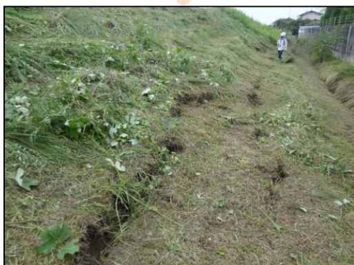
被災状況(松山市垣生地先)
