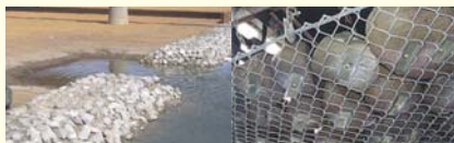
ヨシ生育基盤の前面には、河岸侵食を防止する侵食防止護岸 (自然石固着金網工) を設置しました。
