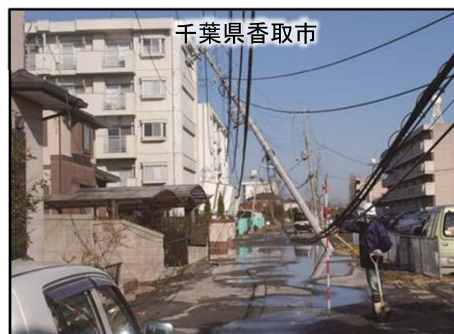
【沿道民地の電柱が倒壊し道路閉塞した例】
