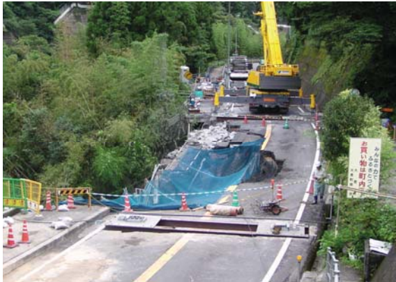
道路崩落箇所状況
