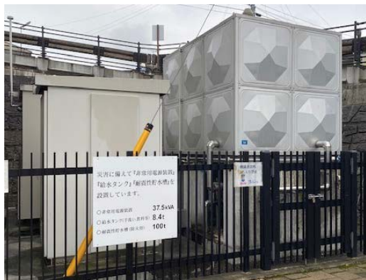
非常用電源装置、貯水槽（手洗、飲料等）
