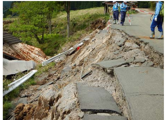
【南阿蘇村 村道被災現地調査】
