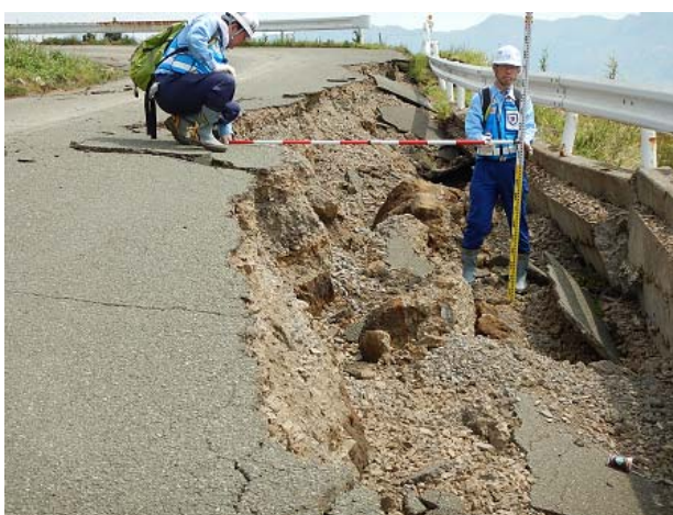
【南阿蘇村 村道被災現地調査】
