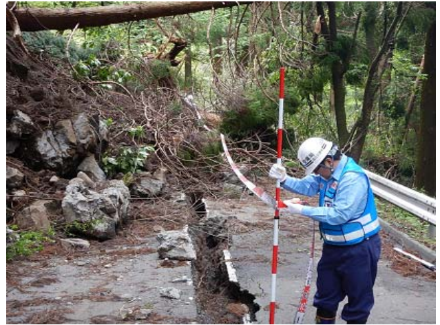
【南阿蘇村 村道被災現地調査】
