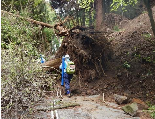
【南阿蘇村 村道被災現地調査】
