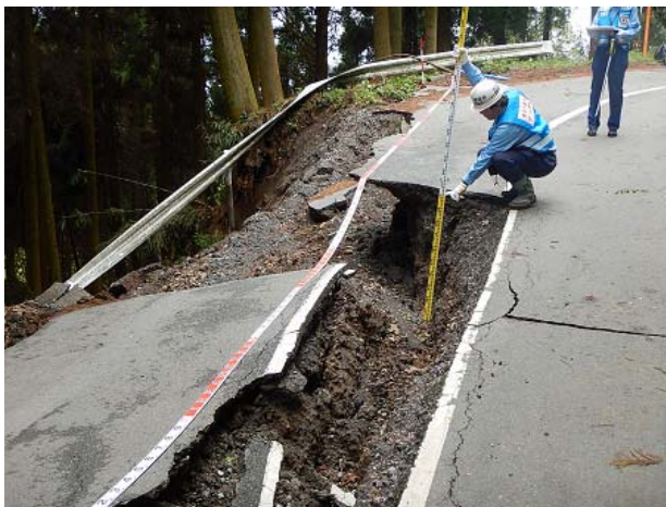
【南阿蘇村 村道被災現地調査】
