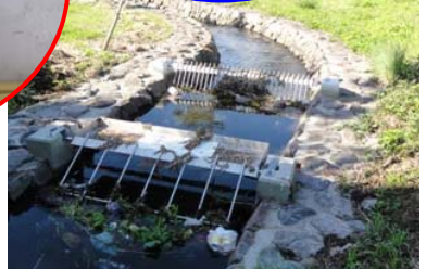
刈草、野菜くず、ビニル袋等によりすぐに目詰まり
