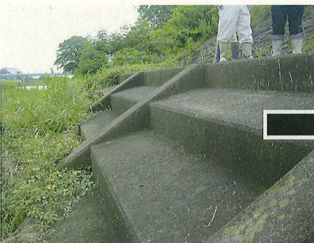
低水護岸が滑りやすくなっていた
