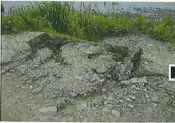
低水河岸の掘れ
