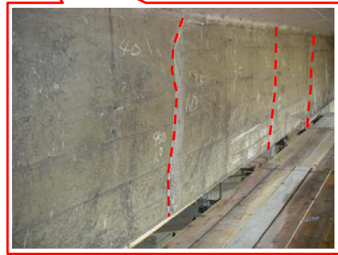
主桁に発生したひび割れ【H20】
