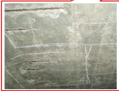
床版の鉄筋露出【H20】
