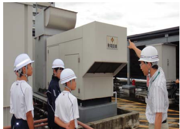
庁舎屋上の非常用発電機の見学
