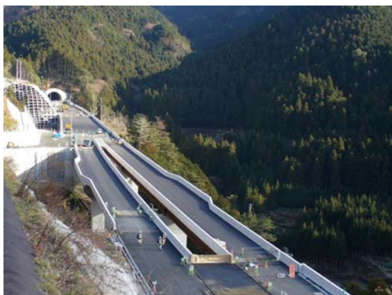
写真① つづら川地区(H24.1.26撮影)
