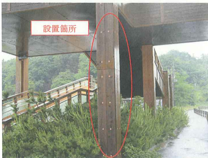
設置箇所の拡大写真
