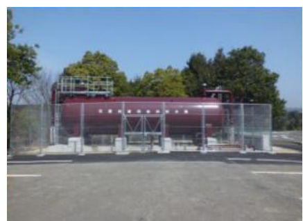
災害に備えた飲料貯水槽
