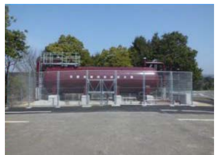
災害に備えた飲料貯水槽
