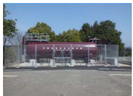
災害に備えた飲料貯水槽
